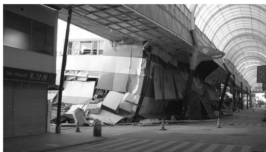
アーケードが一部落下する
