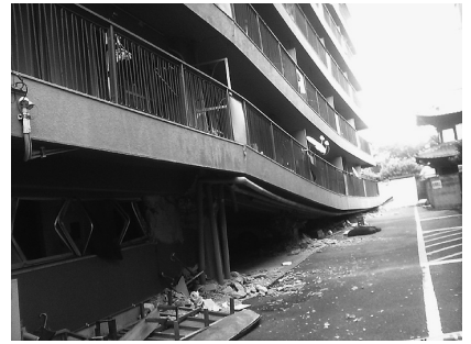
1階駐車場が潰れたマンション
