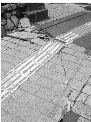
めくれ上がった歩道
